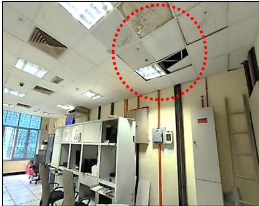
Bilik Kawalan CCTV - Siling Yang Rosak (17.04.2025) (Sumber : UAD KUSKOP)
