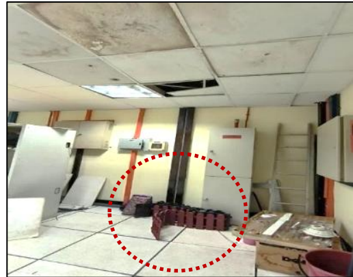
Bilik Kawalan CCTV - Barang Yang Tidak Berkenaan Diletakkan Dalam Bilik CCTV (17.04.2025) (Sumber : UAD KUSKOP)
