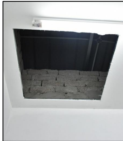
Tamu Desa Kg. Kudar, Kota Marudu - Penutup Ruang Siling Tidak Disediakan (04.11.2025) (Sumber : UAD KUSKOP)
