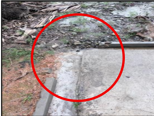
Tamu Desa Kg. Gaur, Kota Belud - Longkang Pecah (05.11.2025) (Sumber : UAD KUSKOP)
