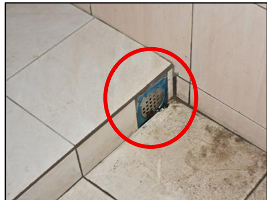
Tamu Desa Kg. Togudon, Penampang - Floor Trap Tidak Berfungsi (06.11.2025) (Sumber : UAD KUSKOP)
