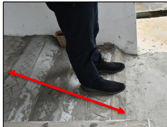
Tamu Desa Kg. Gaur, Kota Belud - Tangga Atau Tanjakan (Ramp) Tidak Kemas/Tidak Siap (05.11.2025) (Sumber : UAD KUSKOP)
