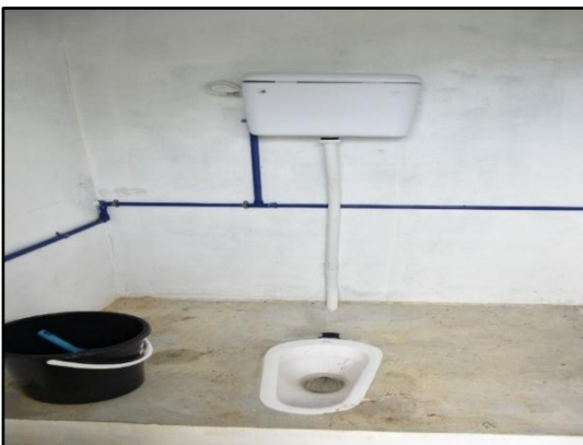
Tamu Desa Kg. Pinolobuh, Kota Belud - Tiada pemasangan jubin lantai dan dinding pada tandas (05.11.2025) (Sumber : UAD KUSKOP)
