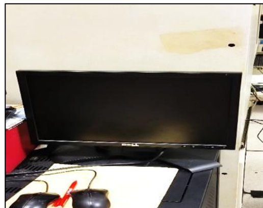
Bilik Kawalan CCTV - Monitor Tidak Berfungsi (17.04.2025) (Sumber : UAD KUSKOP)
