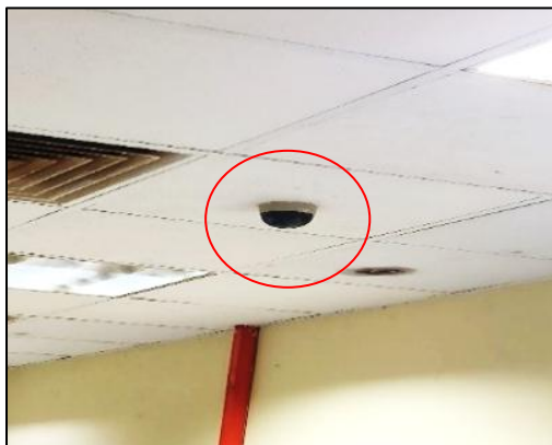
Bilik Kawalan CCTV - CCTV Dalam Bilik Sekuriti (17.04.2025) (Sumber : UAD KUSKOP)
