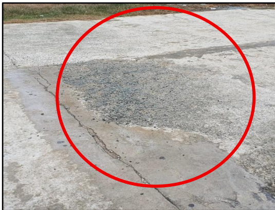
Tamu Desa Kg. Marak Parak, Kota Marudu - Sebahagian Lantai Konkrit Simen Gred 25 di Kawasan Terbuka Telah Pecah (04.11.2025) (Sumber : UAD KUSKOP)
