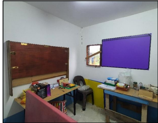
Tamu Desa Kg. Sosondoton Piasau, Kota Belud - Tiada pemasangan tingkap kesmen aluminium (04.11.2025) (Sumber : UAD KUSKOP)
