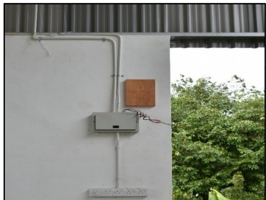
Tamu Desa Kg. Pinolobuh, Kota Belud - Tiada pemasangan meter elektrik (05.11.2025) (Sumber : UAD KUSKOP)
