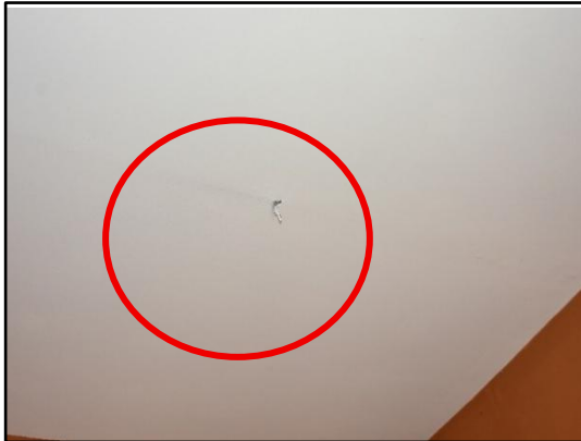
Tamu Desa Kg. Babagon, Penampang - Lampu Siling Tidak Dipasang (06.11.2025) (Sumber : UAD KUSKOP)
